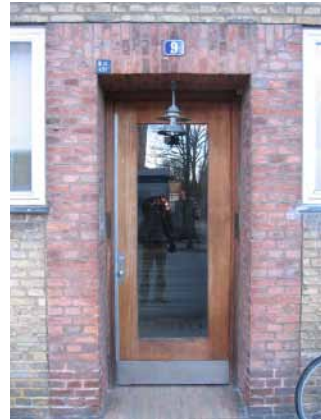
15. Ramme-/gitterdør med glas. Dør med ramme, i hvilken der er en stor rude, der kan være afskærmet med tremmer/gitter. Almindelig for etageejendomme fra 1930'erne og i parcelhuse.
